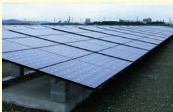
太陽光発電施設の設置例
