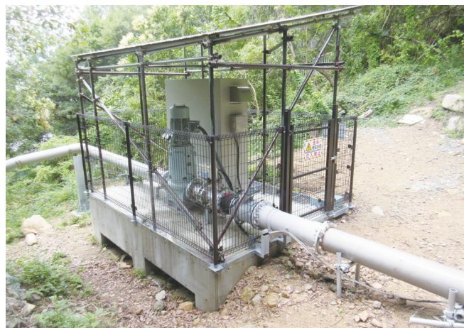
六甲川小水力発電施設
