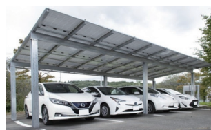
▲カーポート一体型太陽光発電システム
