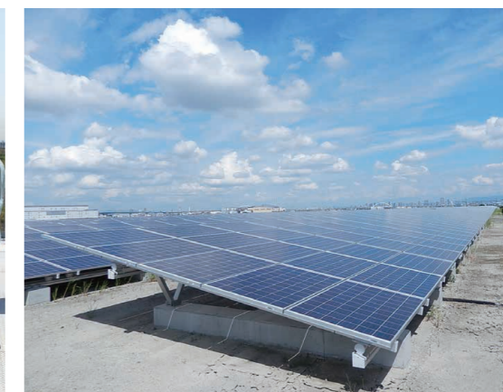
太陽光モジュール(エコひょうご尼崎発電所)
