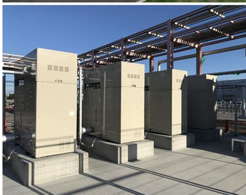
バイオガス発電設備 25kW×4基
